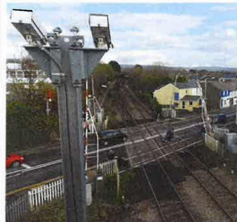
DTS CCTV Column (Polecat)
